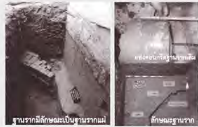
รูปที่ 7 ฐานรากแผ่ของอาคารรองรับตลอดแนวมั่นทุกด้าน
