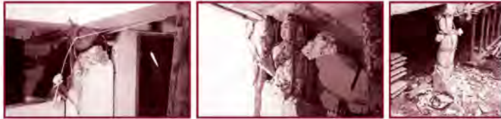
รูปที่ 1 ความเสียหายของโครงสร้างเสาเนื่องจากการโอเวอร์โหลดไม่เพียงพอ
