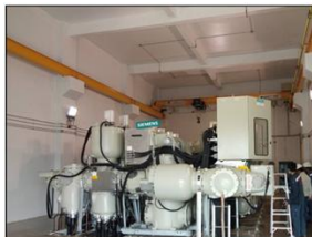
ตรวจสอบความพร้อมก่อนจ่ายไฟ
