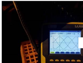
จ่ายไฟฟ้า และบันทึกค่าทุก 1 ชั่วโมง
