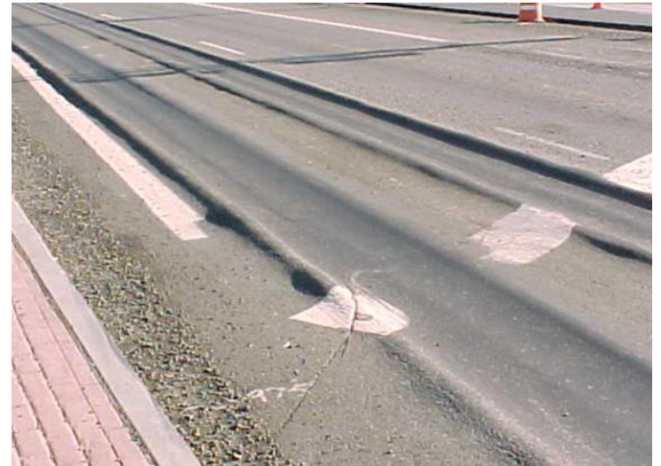
รอยร่องล้อ (Rutting depth)
