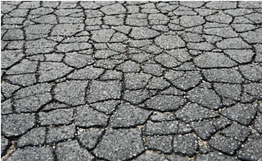
รอยแตกแบบผิวจระเข้ (Alligator crack)
