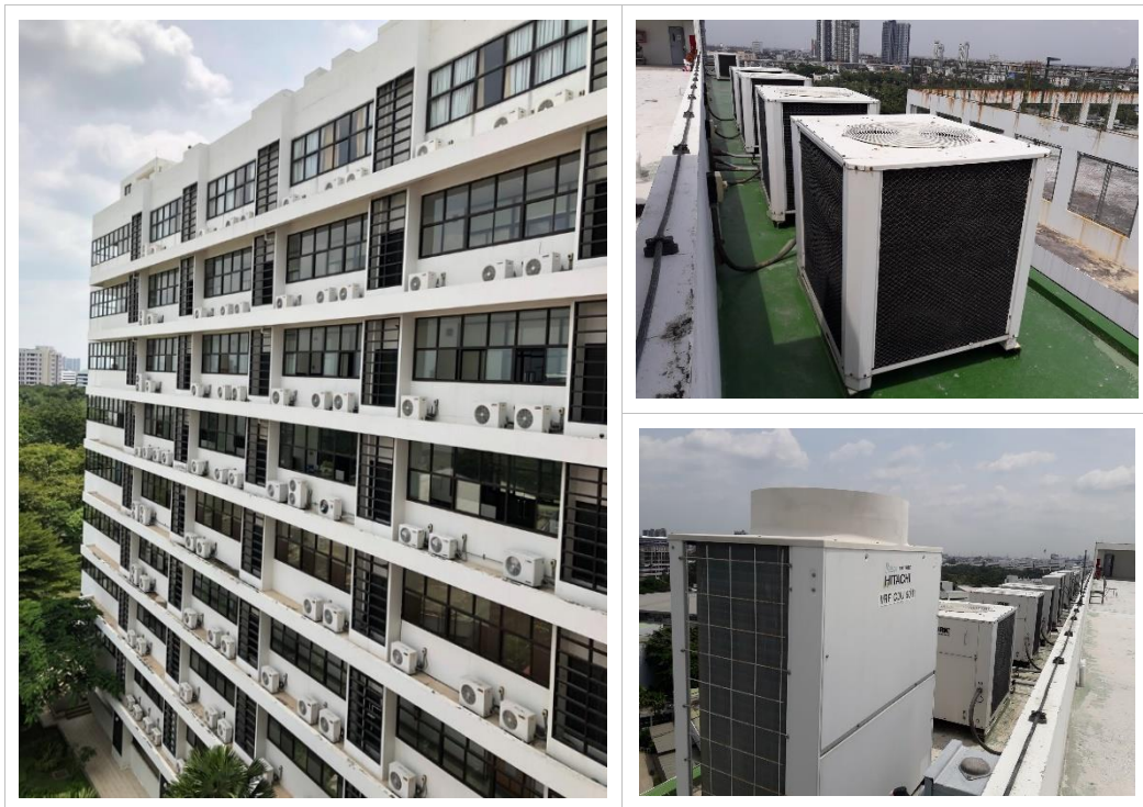
รูปที่ 77 ตำแหน่งติดตั้ง CDU
