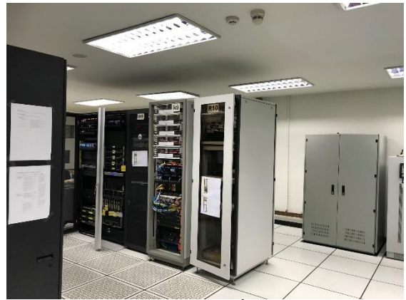
ห้อง server (ชั้น 7)
