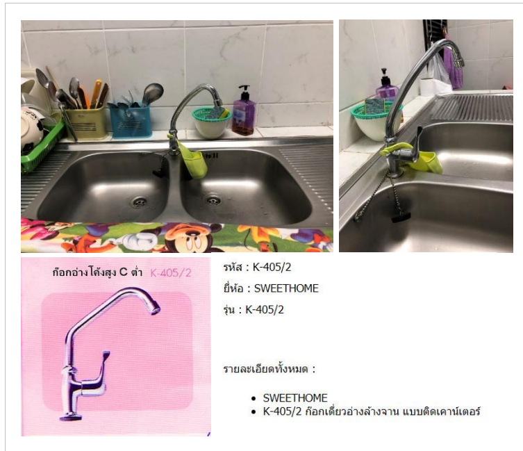
รูปที่ 47 ก๊อกน้ำสำหรับอ่างล้างจาน
