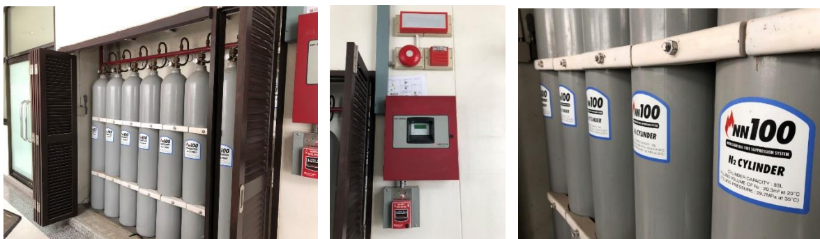
รูปที่ 95 ระบบดับเพลิงอัตโนมัติด้วยสารสะอาดก๊าซไนโตรเจน (IG-100)
