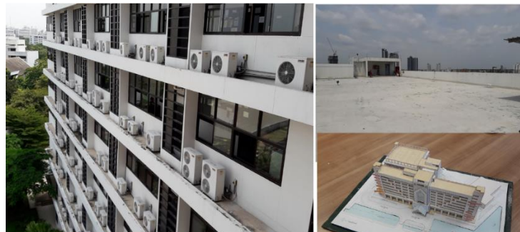
รูปที่ 69 สภาพการติดตั้งระบบปรับอากาศและคาน้ำฟ้าอาคาร
