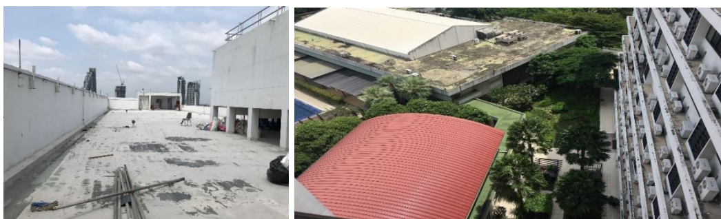
รูปที่ 40 หลังคาตาดฟ้าคอนกรีตทากันซึมสีเขียวสภาพผิวลอก และหลังคาแผ่นเหล็กโค้งสีแดง
