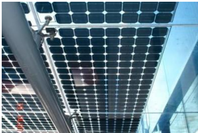
รูปที่ 86 การใช้ PV glass เป็น skylight และผลิตไฟฟ้าในขณะเดียวกัน
