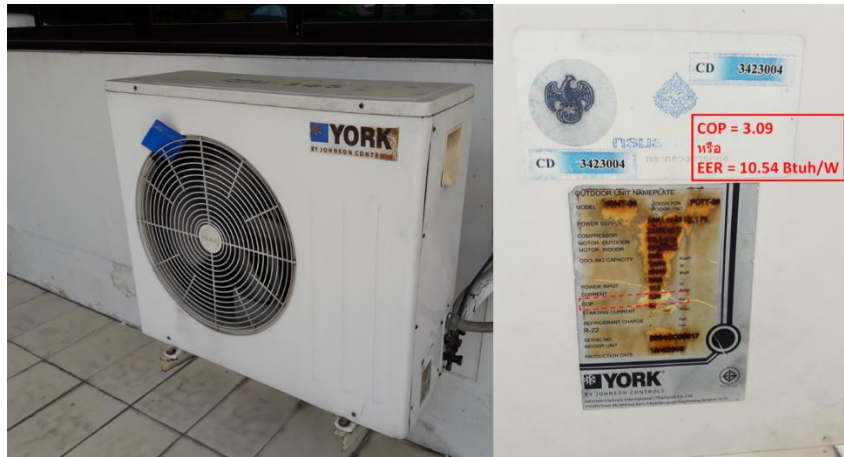
รูปที่ 68 ระบบปรับอากาศที่ใช้ในโครงการพร้อมสมรรถนะเครื่อง
