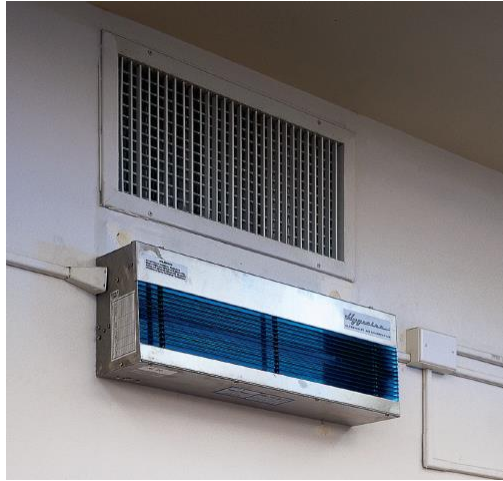
รูปที่ 60 การติดตั้งระบบ UVGI ชนิดติดตั้งที่ผนัง
