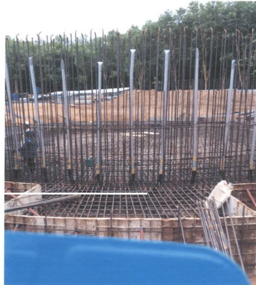
ภาพแสดงท่อ Sheath ของลวดยึดแรงแนวตั้งกับ Loop Dead End
