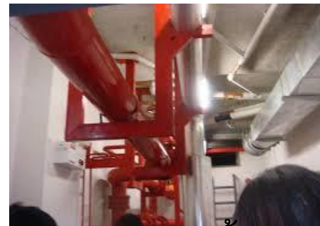
ท่อขึ้น ถังเก็บน้ำสำรอง เพื่อการดับเพลิง
