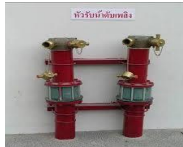
หัวรับน้ำดับเพลิงจากนอก อาคารเติมเข้าระบบ
