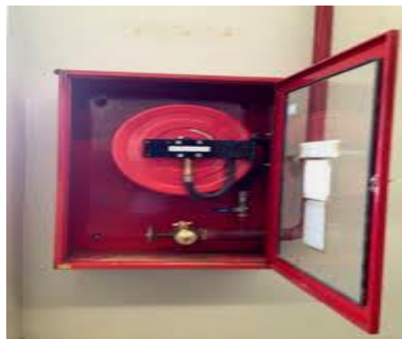
ตู้สายฉีดน้ำดับเพลิงที่มี หัวต่อสายฉีดน้ำดับเพลิง ของพนักงานดับเพลิงได้
