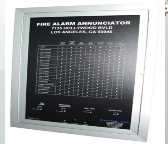
จอแสดงสถานะไฟไหม้ (ตำแหน่งที่เกิดไฟไหม้)
