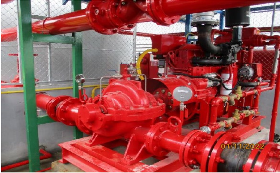
เครื่องสูบน้ำดับเพลิง
