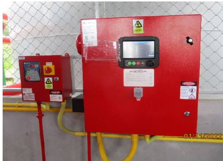
ตู้ควบคุม
