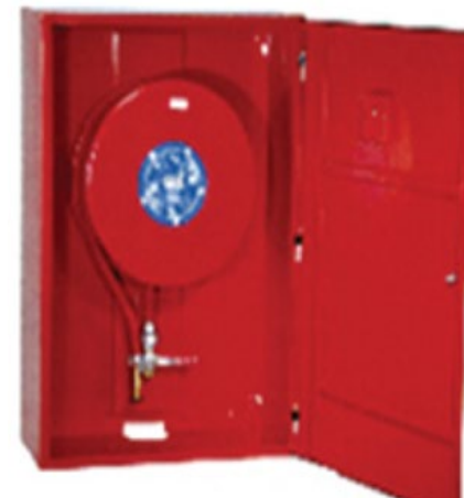
ชุดสายฉีดน้ำดับเพลิง Hose Reel ขนาด 1 นิ้ว
