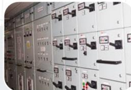
3. ระบบไฟฟ้าและ ควบคุม
