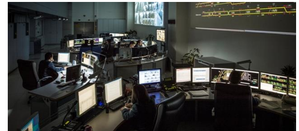
ด้านระบบอัตโนมัติสัญญาณ
