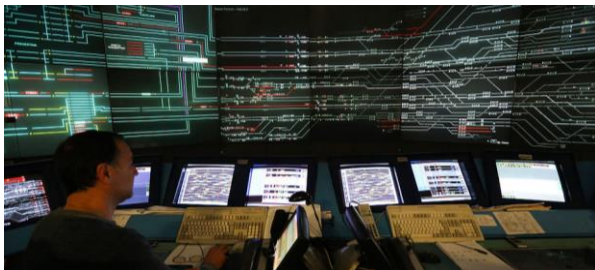
ด้านระบบควบคุมและเก็บข้อมูล
