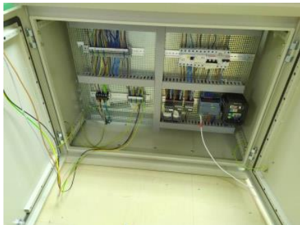
ชุดควบคุมด้วย PLC
