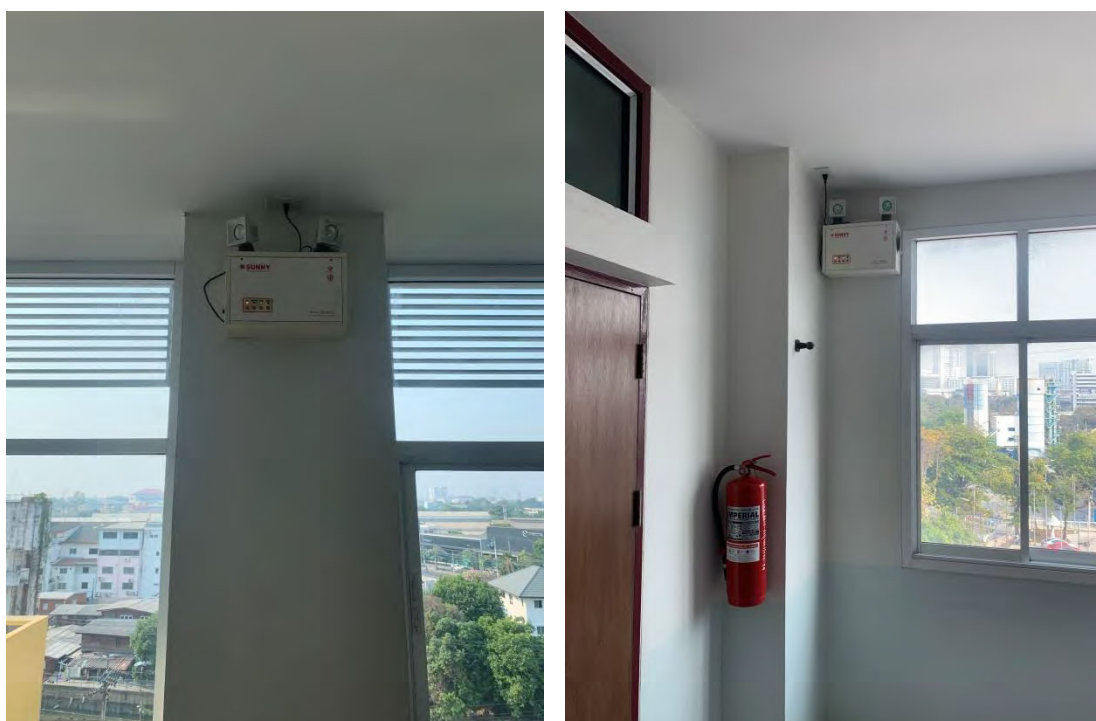
รูปที่ 108 ไฟสำรองแสงส่องสว่าง 2 เครื่อง (บันไดบริเวณพื้นที่เอนกประสงค์ 1 เครื่อง และข้างบันไดหนีไฟ 1 เครื่อง)
