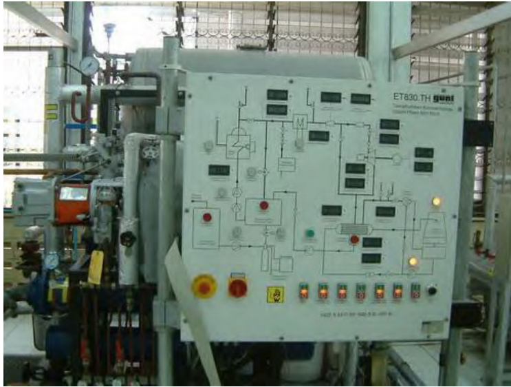
รูปที่ 88 Steam Power Plant
