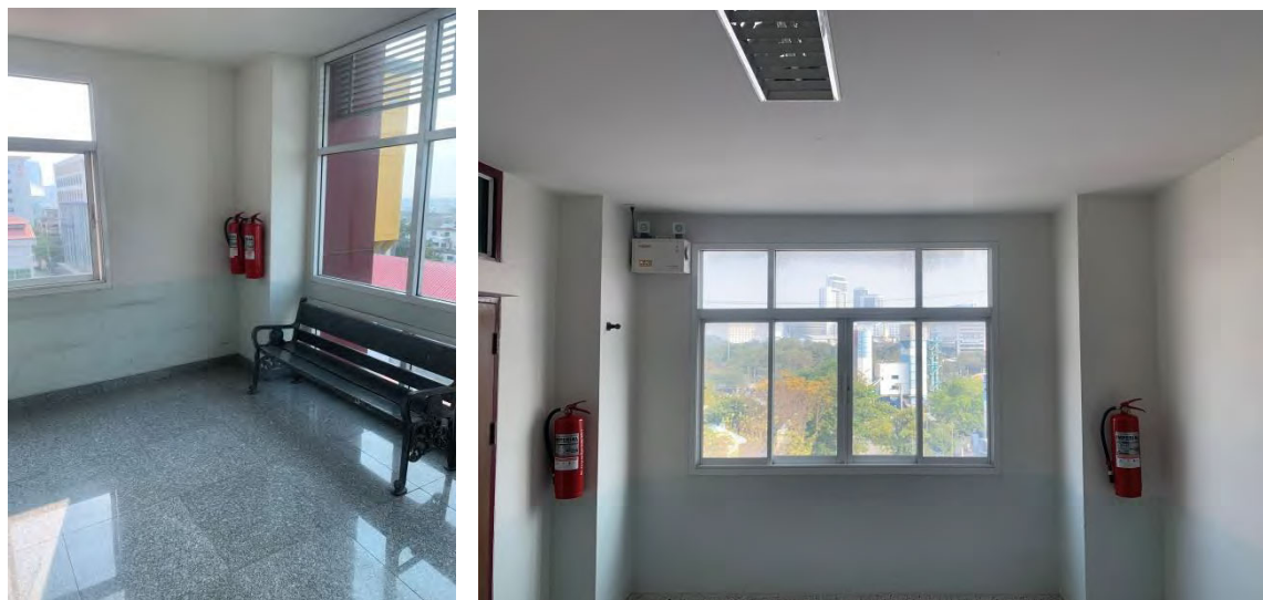
รูปที่ 107 ถังดับเพลิงจำนวน 4 ถัง (บันไดบริเวณพื้นที่เอนกประสงค์ 2 ถัง และข้างบันไดหนีไฟ 2 ถัง)
