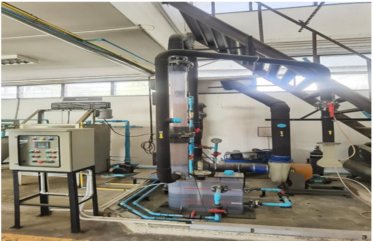
รูปที่ 4 เครื่อง Gas-Liquid Absorber ห้อง Workshop อาคาร EN14
