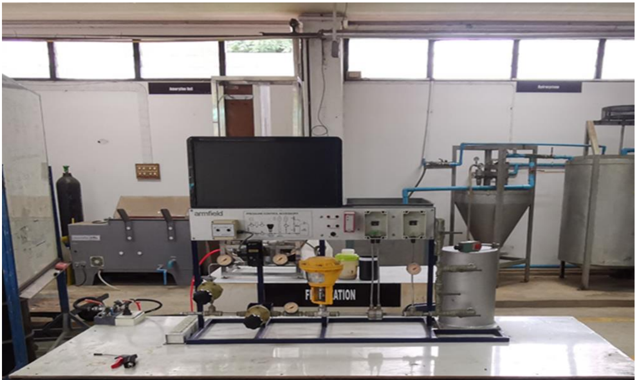
รูปที่ 1 เครื่อง Pressure control ห้อง Workshop อาคาร EN14
