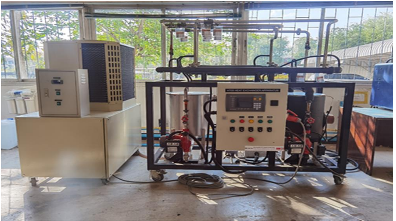
รูปที่ 7 เครื่อง Shell and Tube Heat Exchanger ห้อง Workshop อาคาร EN14
