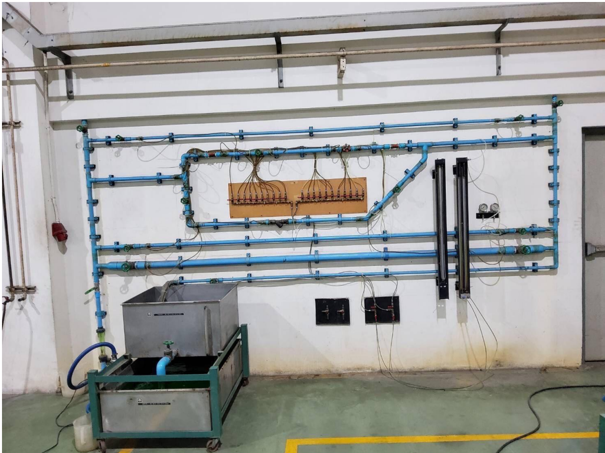
ชุดการทดลอง Piping system including fittings and valves (ห้องปฏิบัติการ อาคารปฏิบัติการ ชั้น 2)
