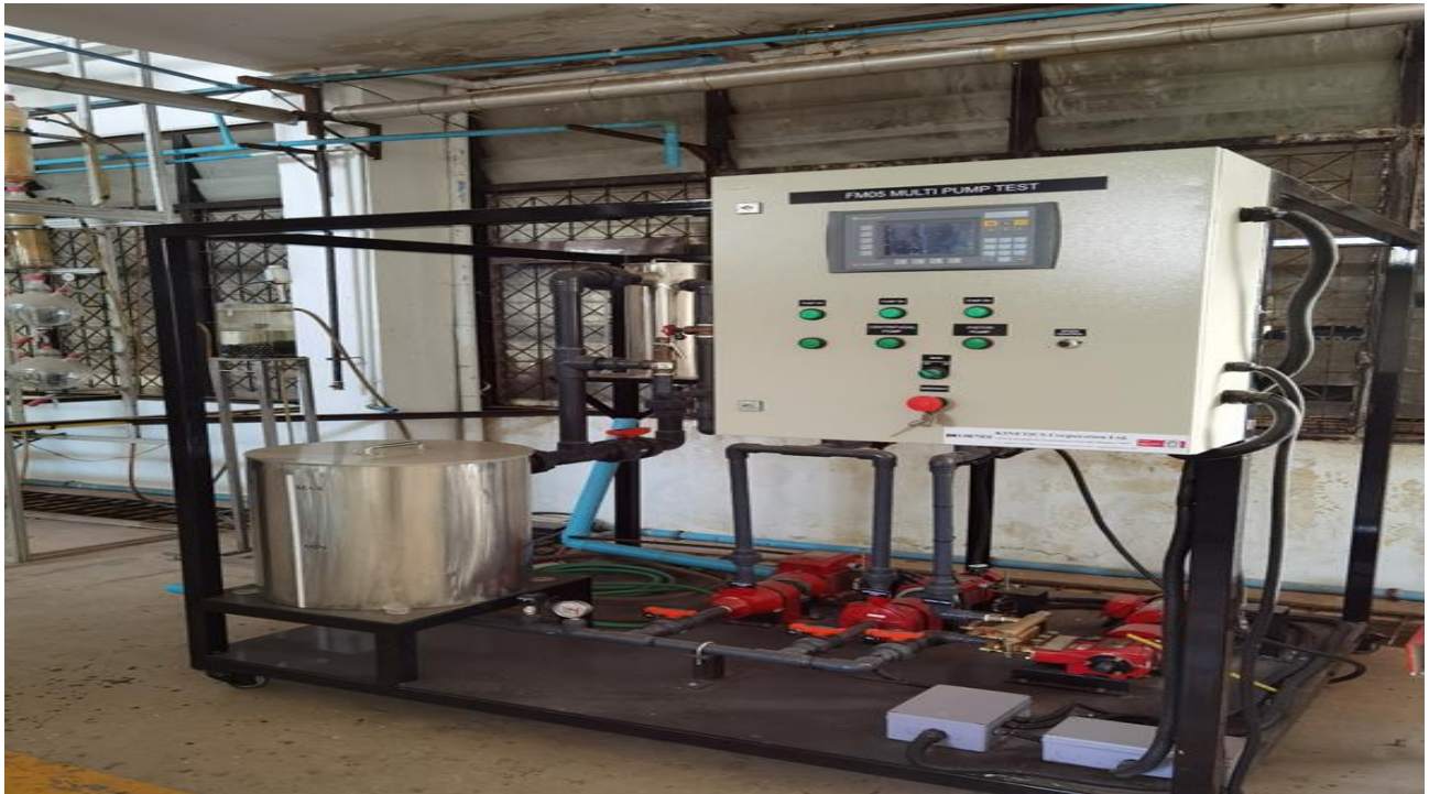
รูปที่ 2 เครื่อง Pump Test ห้อง Workshop อาคาร EN14
