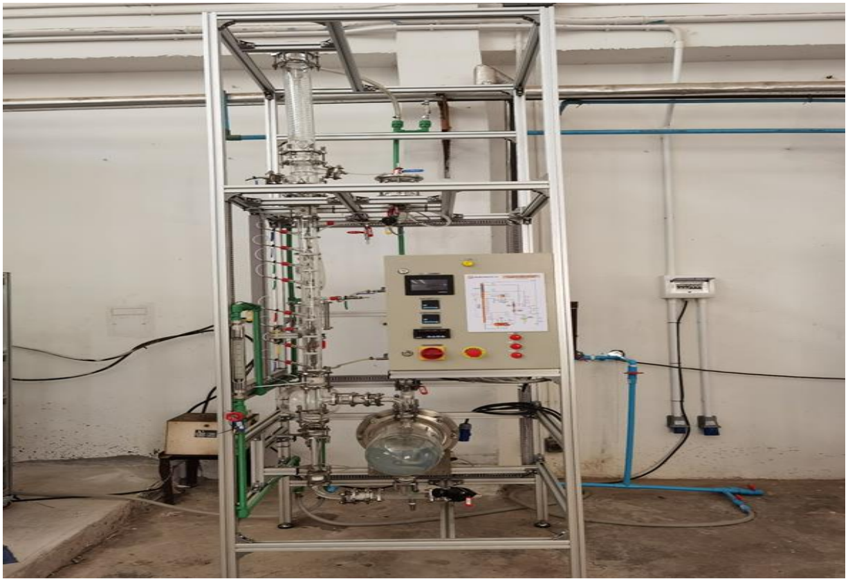
รูปที่ 15 เครื่อง Batch Distillation ห้อง Workshop อาคาร EN14
