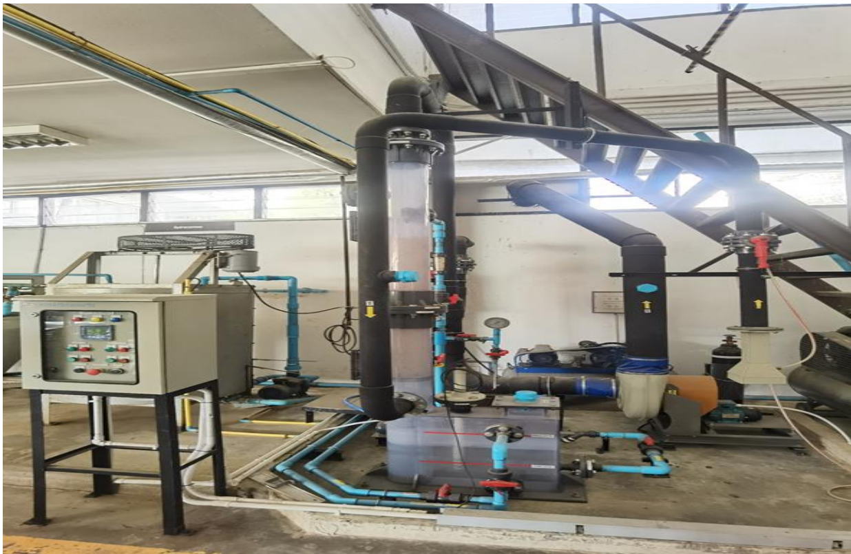
รูปที่ 12 เครื่อง Gas-Liquid Absorber ห้อง Workshop อาคาร EN14
