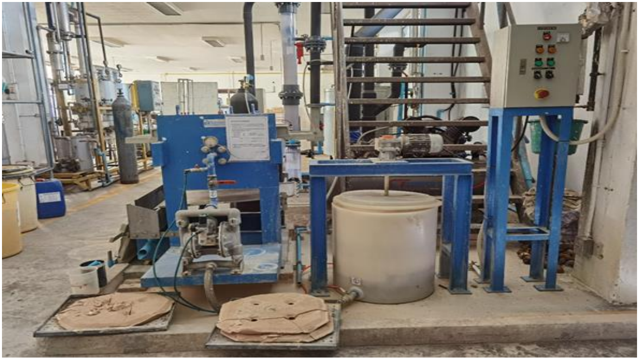
รูปที่ 3 เครื่อง Plate and frame (Filter Press) ห้อง Workshop อาคาร EN14
