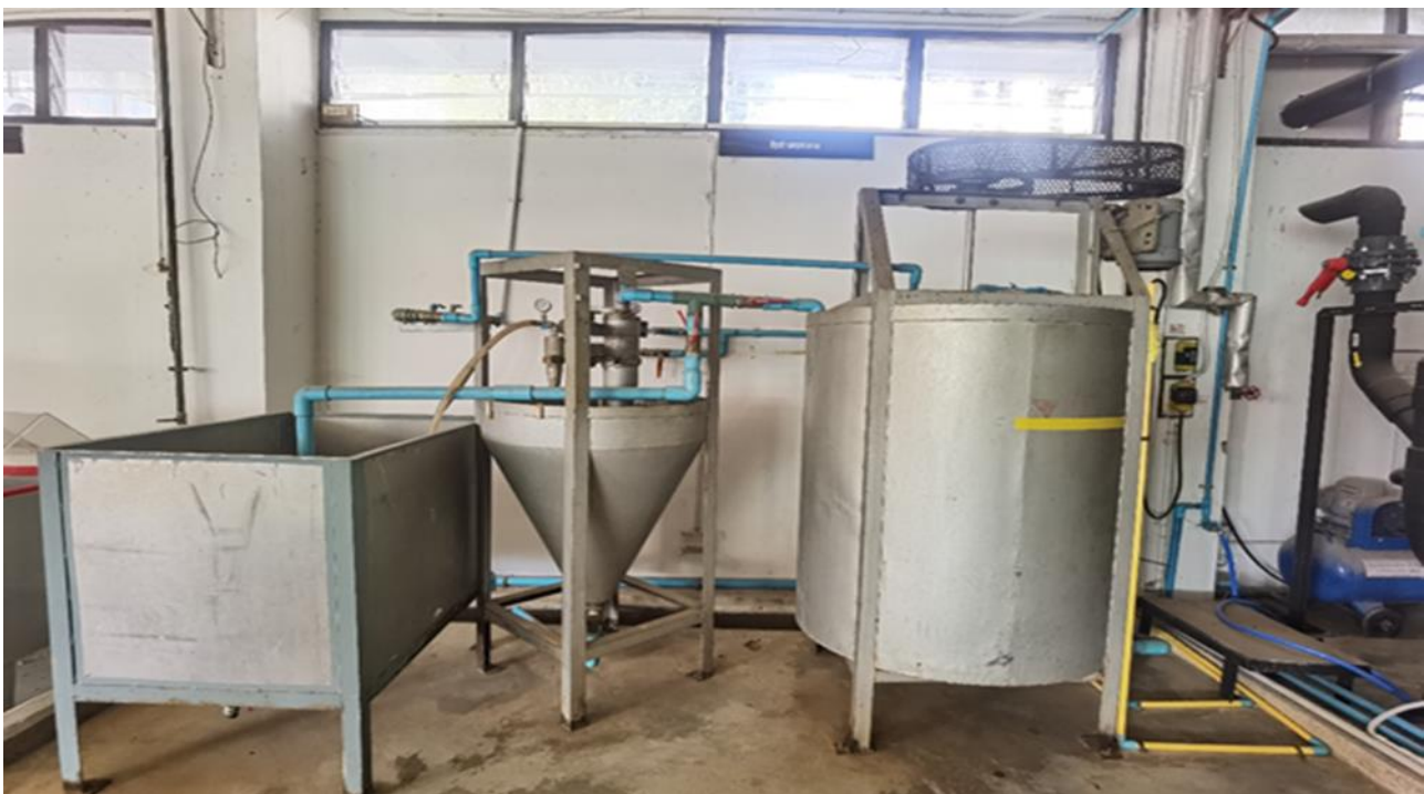
รูปที่ 6 เครื่อง Hydro cyclone ห้อง Workshop อาคาร EN14
