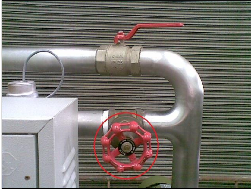
รูปที่ 44 การปิดวาล์วน้ำทางเข้ากังหัน
