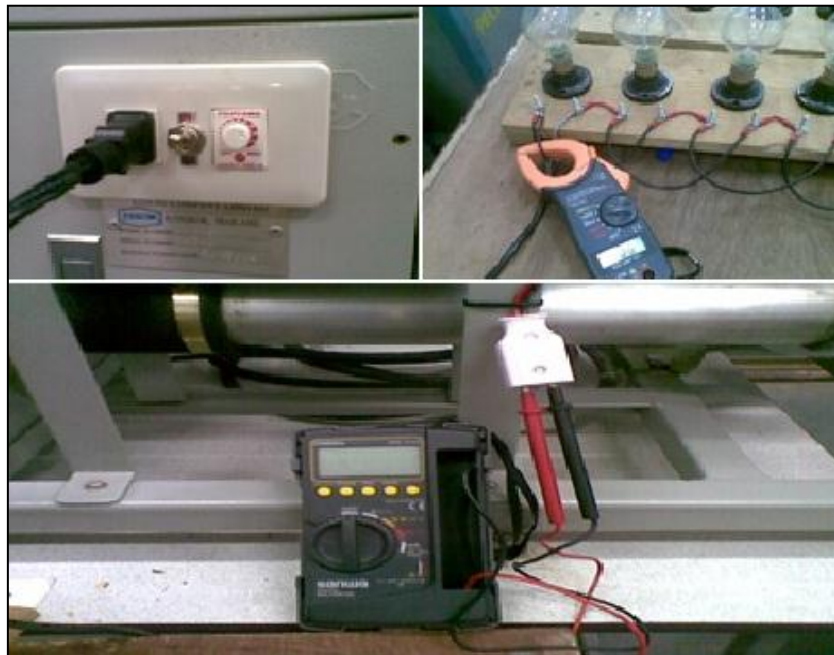
รูปที่ 37 การติดตั้งเครื่องมือวัด
