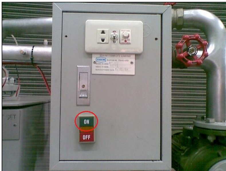
รูปที่ 31 การการกดปุ่ม ON
