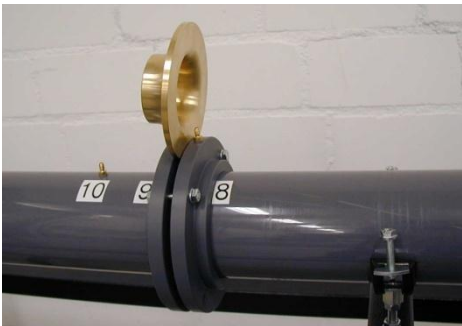
รูปที่ 1 แสดงการติดตั้ง nozzle
