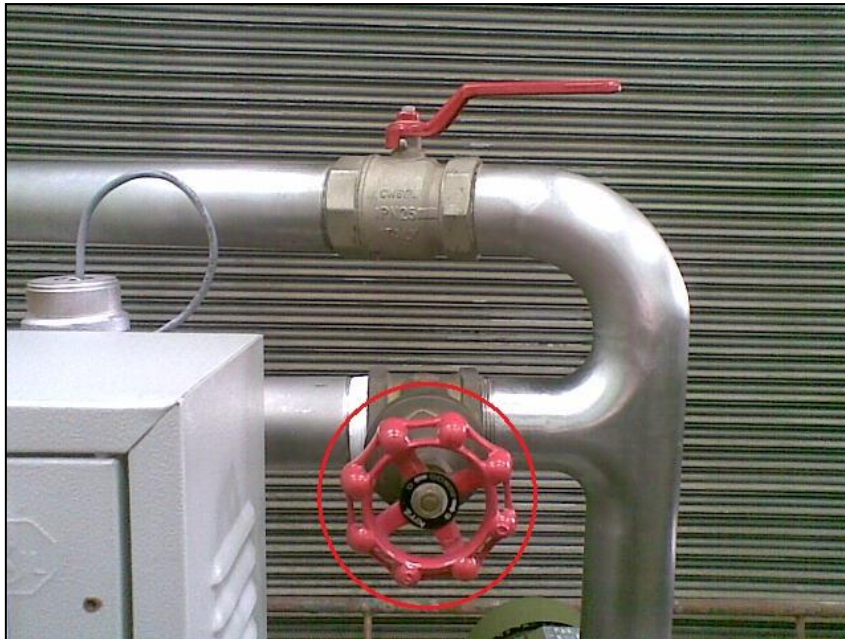
รูปที่ 11 การเปิดวาล์วระบายน้ำเข้าถังหัน
