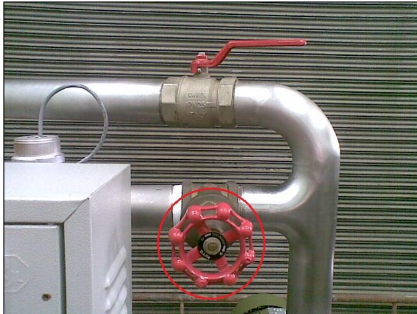
รูปที่ 27 การปิดวาล์วน้ำทางเข้ากังหัน
