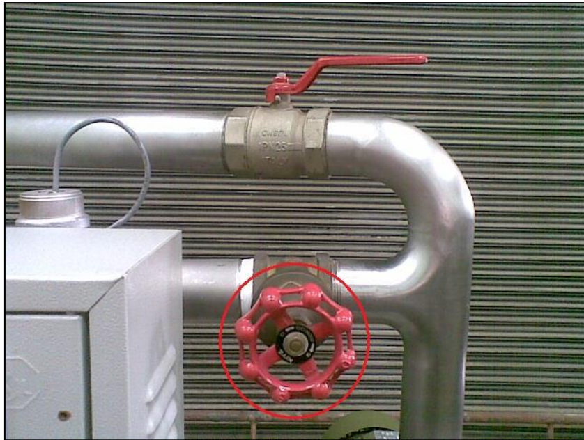
รูปที่ 32 การเปิดวาล์วระบายน้ำเข้าถังหั่น
