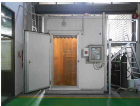
ชุดทดลองห้องทำความเย็น
