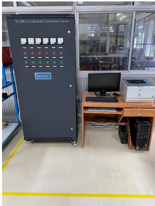
รูปที่ 16 ห้องฝึกจำลองเครื่องเย็น (Chiller Training Room)
