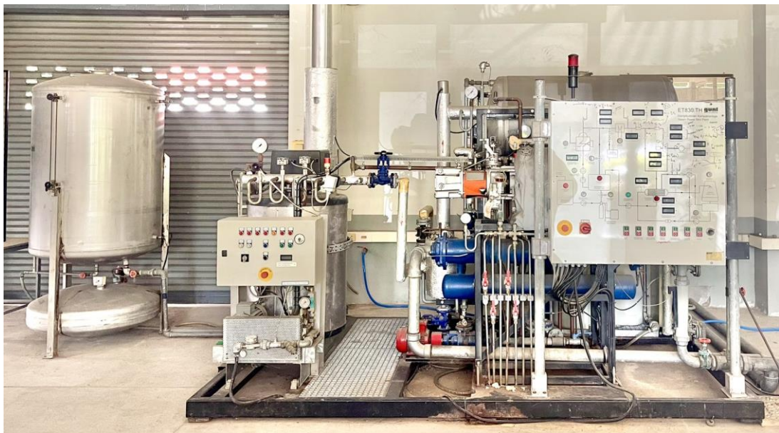
รูปที่ 5.17 ห้องปฏิบัติการเครื่องกำเนิดไอน้ำ (ต่อ)
