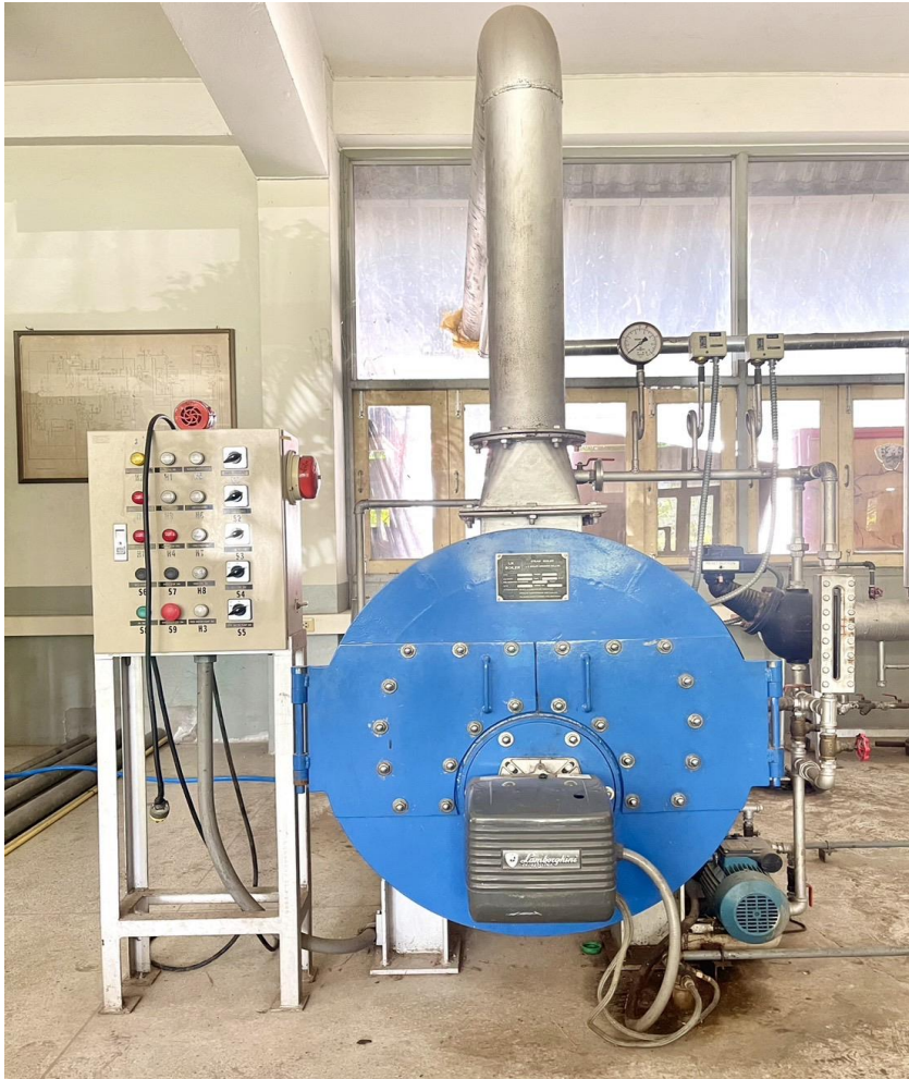
รูปที่ 5.16 ห้องปฏิบัติการเครื่องกำเนิดไอน้ำ
