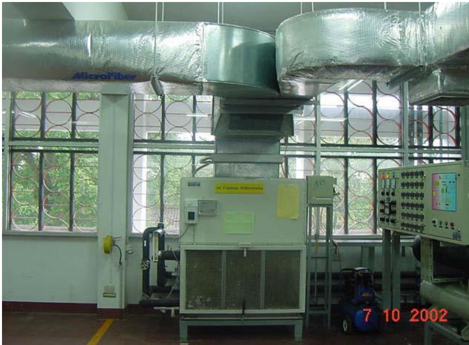
รูปที่ 5.46 Air Conditioning Unit
