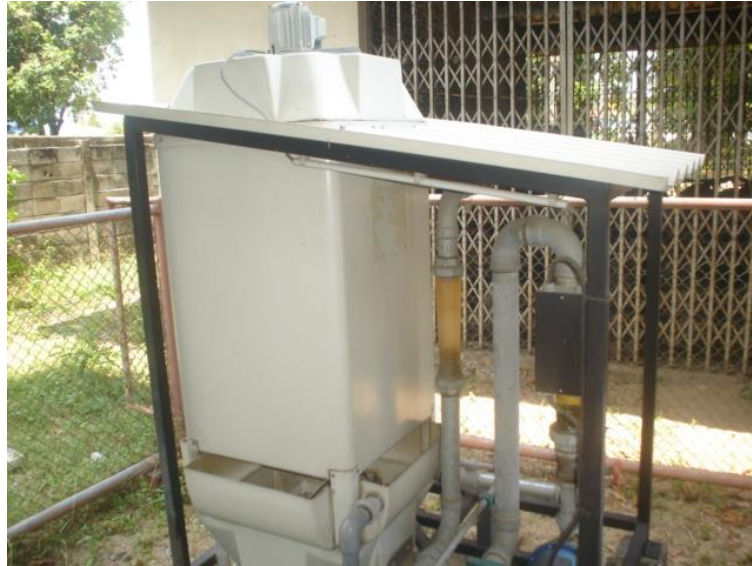
รูปที่ 5.50 Cooling Tower
