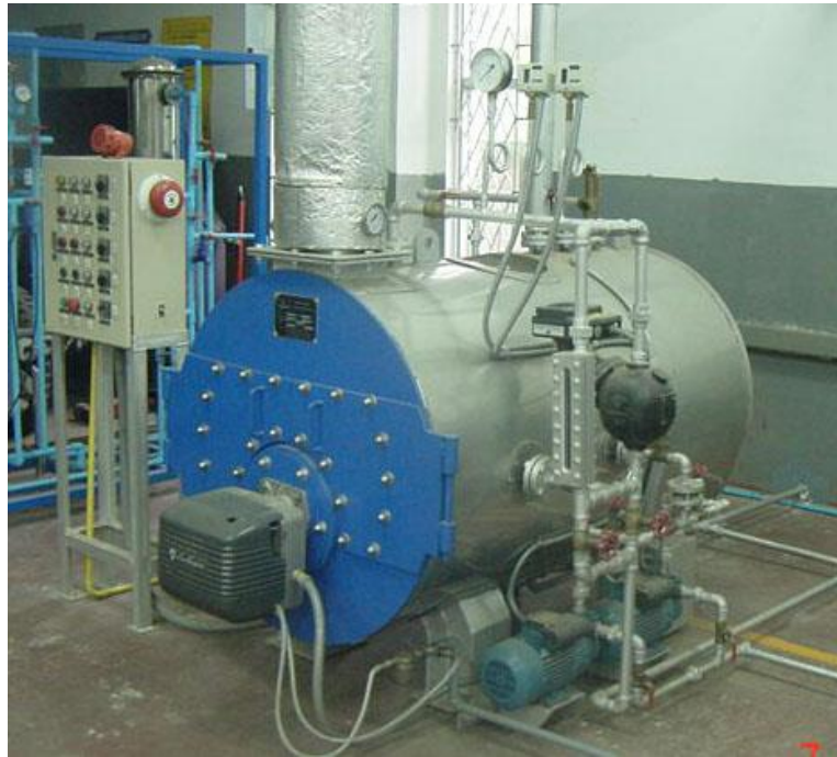
รูปที่ 5.48 Steam boiler
