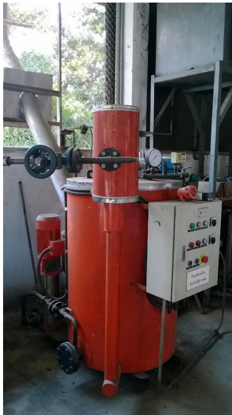
รูปที่ 4.1 Boiler
