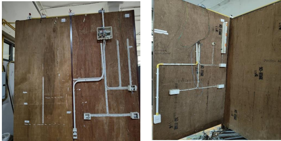
รูปที่ 7 กระดานไม้สำหรับเดินสายไฟฟ้า ห้อง ETB.101
