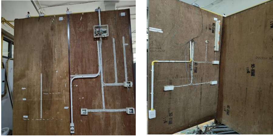
รูปที่ 7 กระดานไม้สำหรับเดินสายไฟฟ้า ห้อง ETB.101
