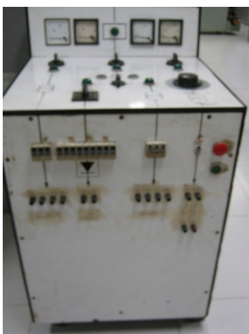
อุปกรณ์ปรับค่าแรงดันไฟฟ้าชนิด 1 เฟส และ 3 เฟส
