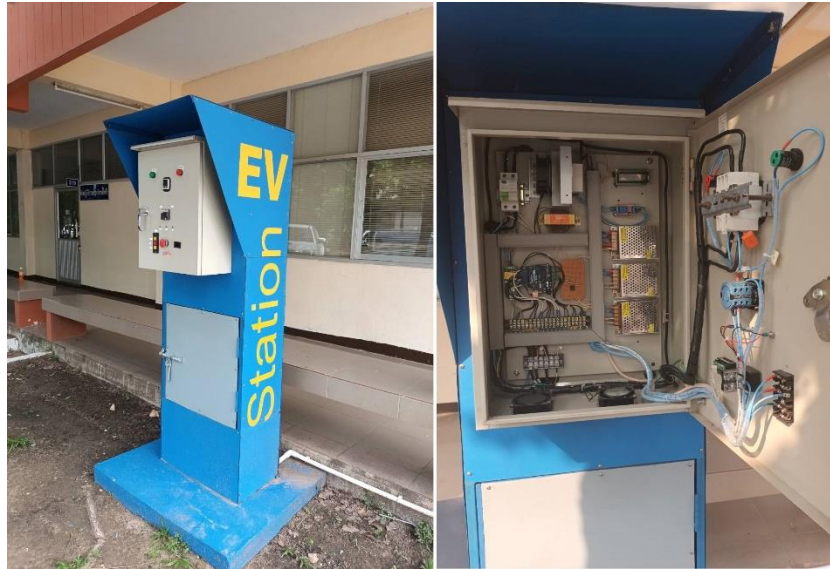
สถานีอัดประจุยานยนต์ไฟฟ้า
