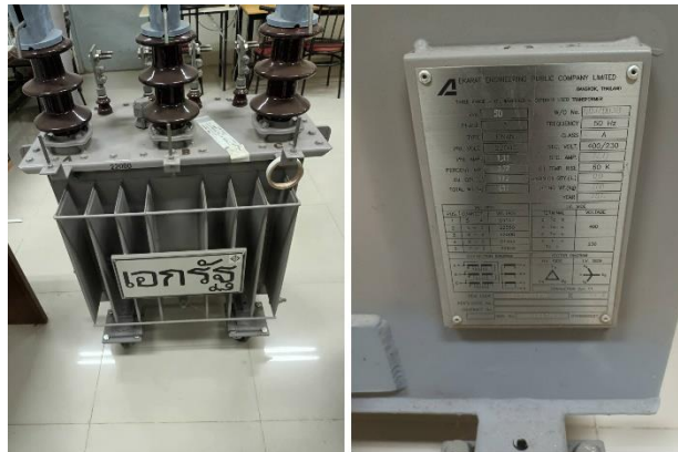
หม้อแปลงไฟฟ้าสามเฟส 50 kV, 50Hz, 22,000-400/230V
