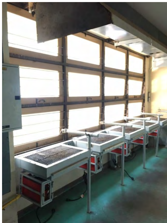
ภาพที่ 17 ชุดดูดอากาศและโต๊ะงานเชื่อมภายในอาคาร 17/1 ชั้นล่าง
