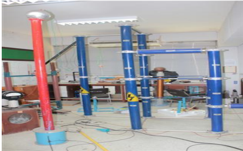
รูปที่ 27 เครื่องกำเนิดไฟฟ้าแรงสูง ชุด KIT มีขนาด 150 KV, 5 mA สร้างขึ้นโดยภาควิชาวิศวกรรมไฟฟ้า
