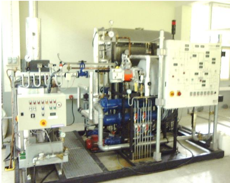
รูปที่ 4.69 Steam Power Plant
