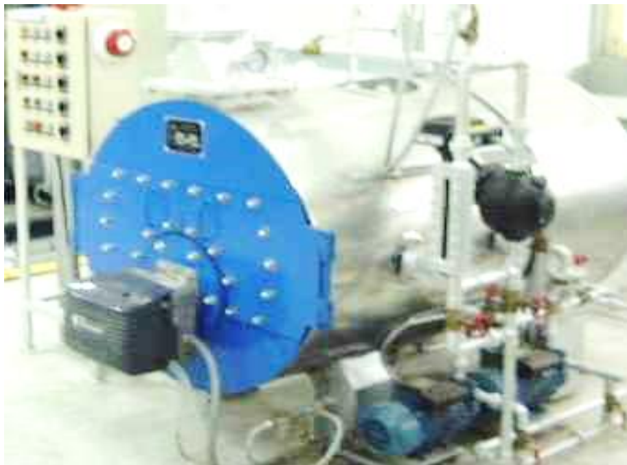
รูปที่ 4.68 Boiler
