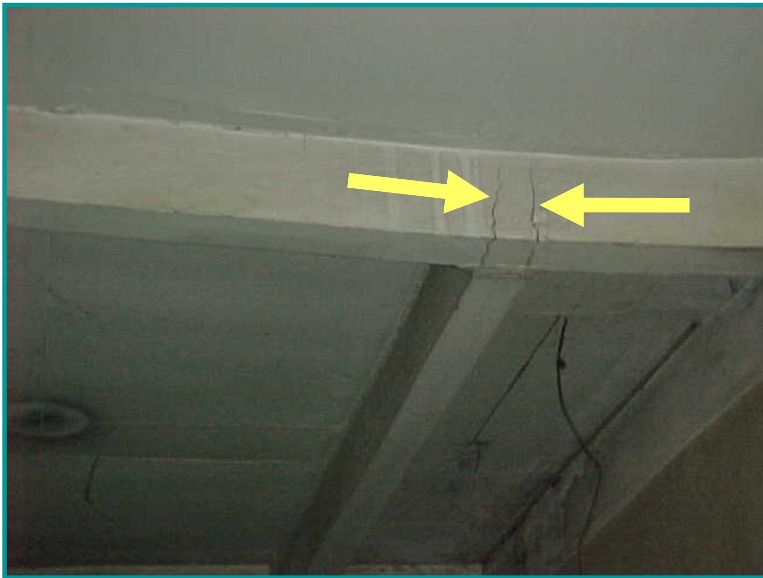
คานหลักเกิดรอยแตกร้าว ที่จุดรับคานซอย
