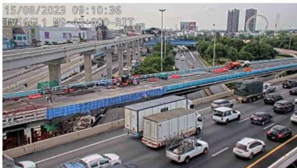
รูปที่ 5-1 ตำแหน่งของสะพานที่เกิดความเสียหาย โดยลักษณะของสะพานเป็นสะพานที่ถ้ำยกรจากถนนรวมอินทรามาเข้าทางหลวงพิเศษหมายเลข 9 ซึ่งในรูปจะเป็นความซับซ้อนของการตัดของเส้นทางคมนาคม เพราะด้านบนเป็นรถไฟรางเดียวสายสีชมพู และด้านล่างของสะพานเป็นส่วนถนนแบ่งของถนนรวมอินทรา ซึ่งจำเป็นต้องปิดถนนชั่วคราวเช่นเดียวกัน
