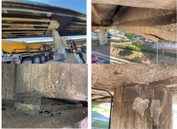
รูปที่ 3.1-4 ความเสียหายที่พบเห็นเชิงประจักษ์ทั้งในส่วนของเกอร์เตอร์ แผ่นยางรองเกอร์เตอร์ เสาค้ำ และคานขวาง
