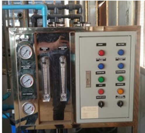
รูปที่ 13.2 เครื่องกรองน้ำระบบ (REVERSE OSMOSIS: RO)
