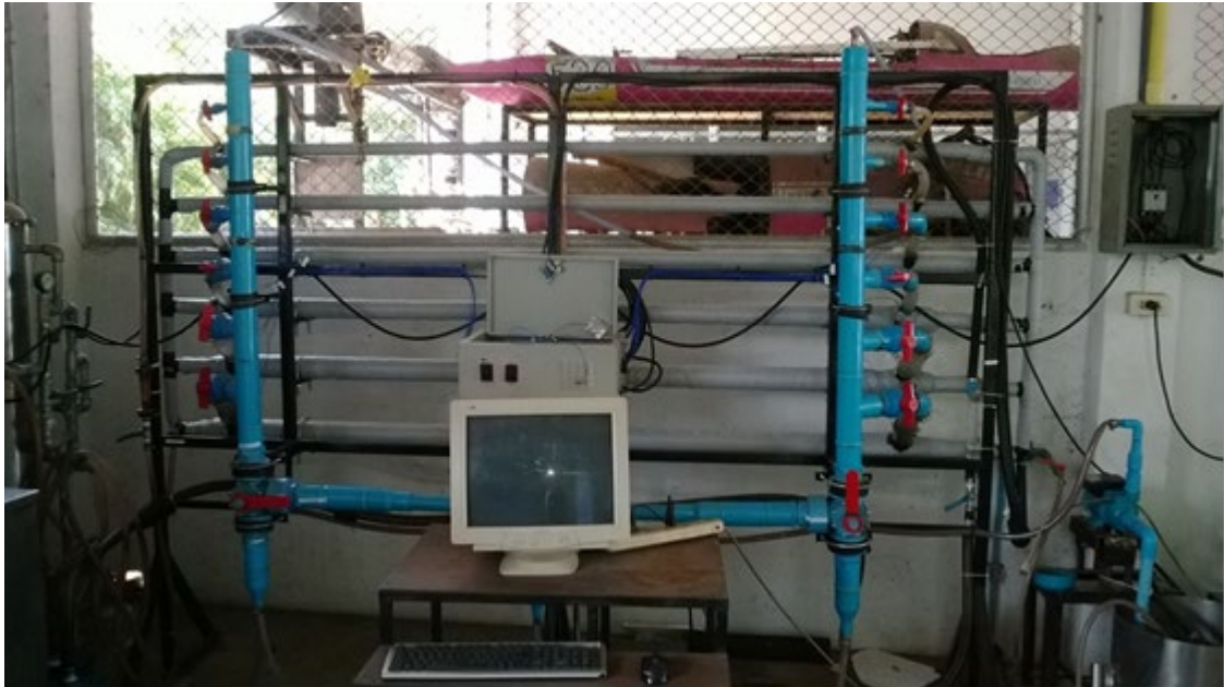
รูปที่ 3.2 Heat Exchanger
