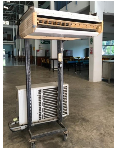
รูปที่ 112 เครื่องปรับอากาศ
