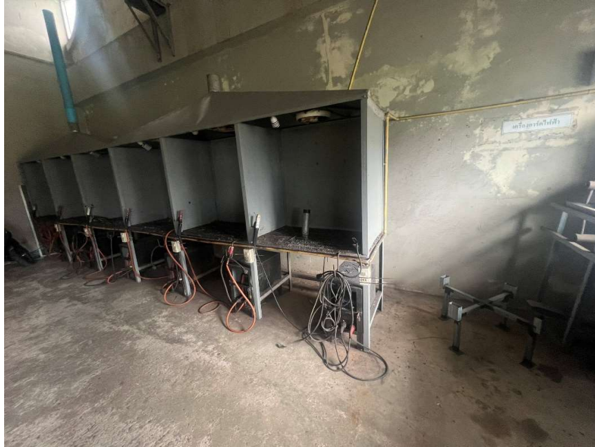
รูปที่ 4.10 ตู้เชื่อมไฟฟ้า
