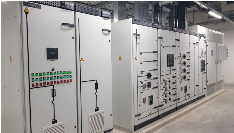
แผงสวิตช์ไฟฟ้าและการติดตั้งตามมาตรฐานฯ...ลือชัย ทองนิล
