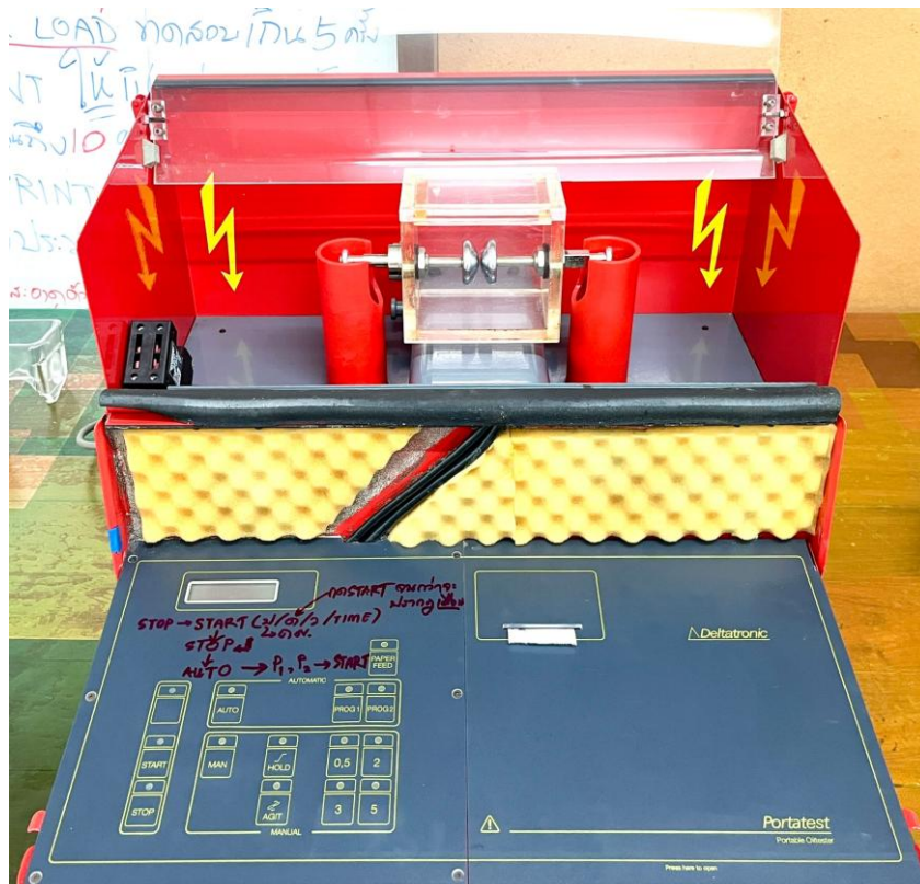
คำอธิบาย : ชุดเครื่องมือทางไฟฟ้าแรงดันสูงใช้ทดสอบน้ำมันหม้อแปลง
