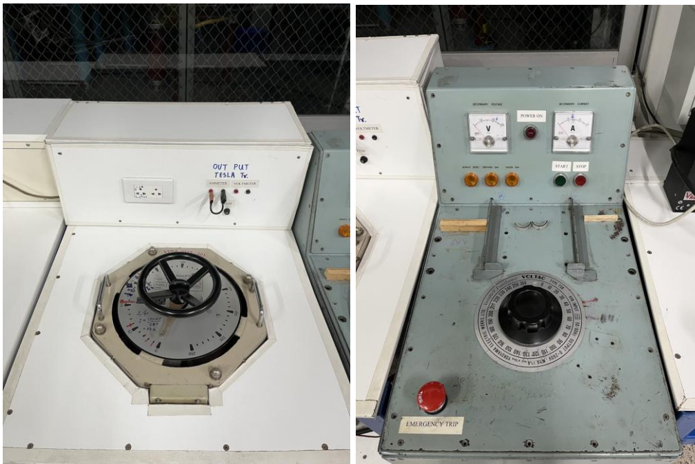
หม้อแปลงปรับแรงดันไฟฟ้าแบบแกนหมุน
