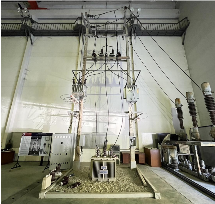
เสาไฟฟ้าจำลองระบบจำหน่าย Distribution
