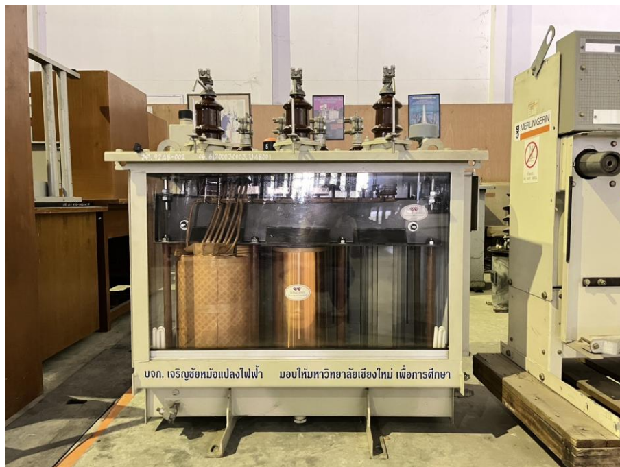
หม้อแปลงไฟฟ้ากำลัง
