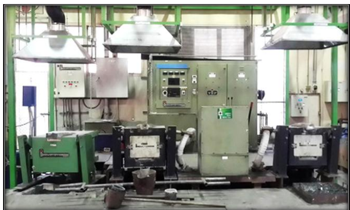
ชุดอุปกรณ์เตาหลอมและชุดควบคุม 2
